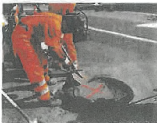
Az elhasználódott fedlap kiemelése.
